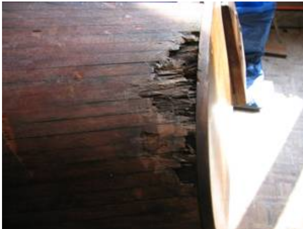
Het te vervangen rotte stuk
